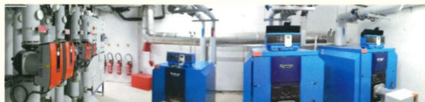
Chaufferie Hôtel du Champs du feu.
