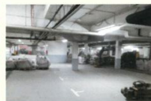
Mise en sécurité - Désenfu- mage SOFITELE Strasbourg
